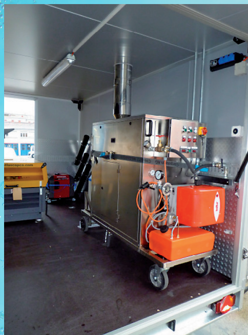
Der Dampf-Erzeuger mobil eingebaut...
